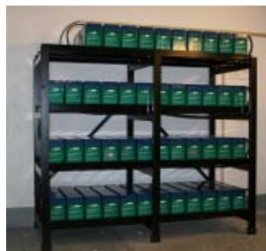
Bilden visar ett typiskt VISION-batteri för UPS. Ställningar för 110V är uppbyggda på motsvarande sätt men med bara två nivåer. Se tabell ovan.
